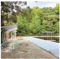
老朽化したプール
